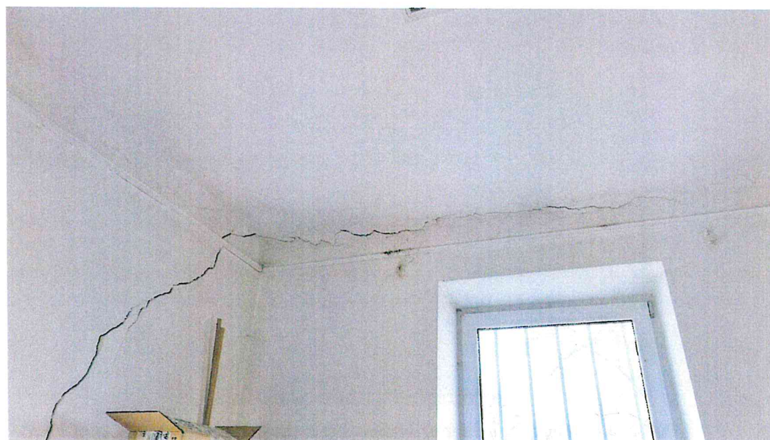
Widoczne uszkodzenia ścian w pomieszczeniu nr 1.
