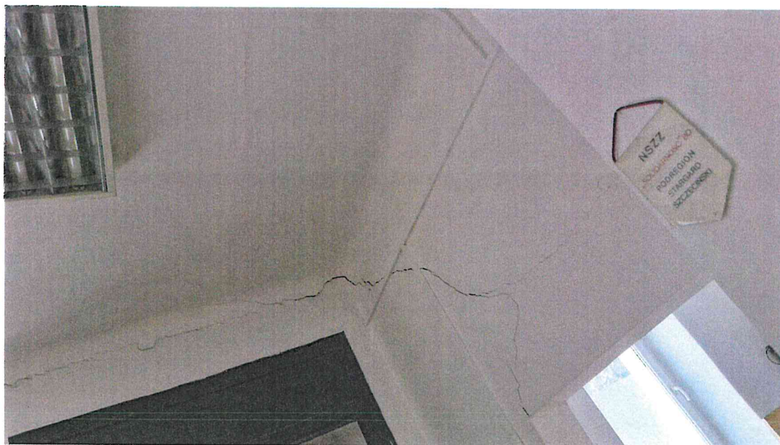
Widoczne uszkodzenia ścian w pomieszczeniu nr 5.
