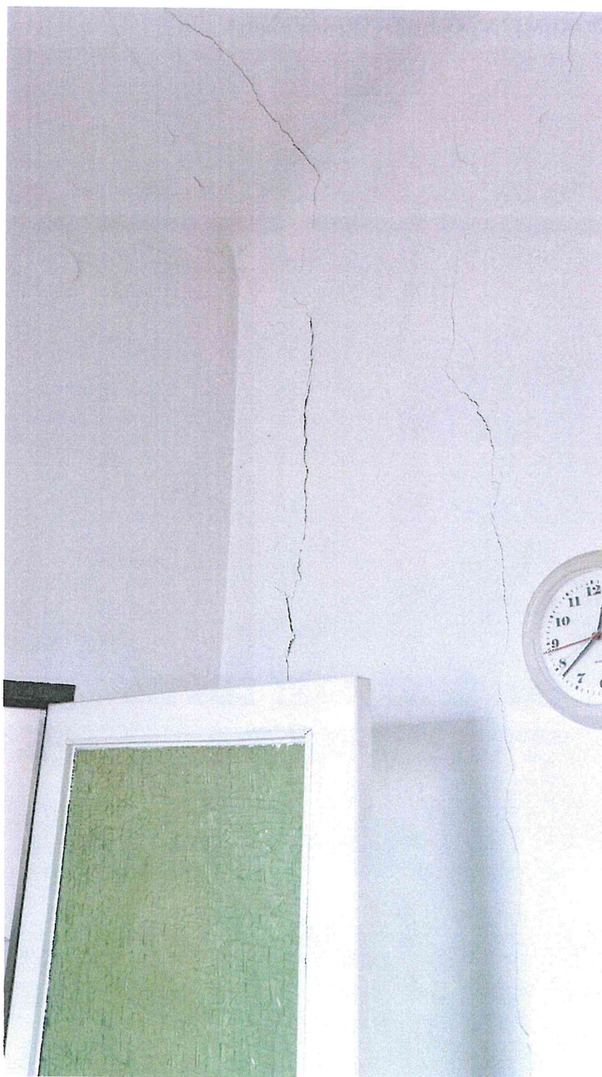
Widoczne uszkodzenia ścian w pomieszczeniu nr 2.
