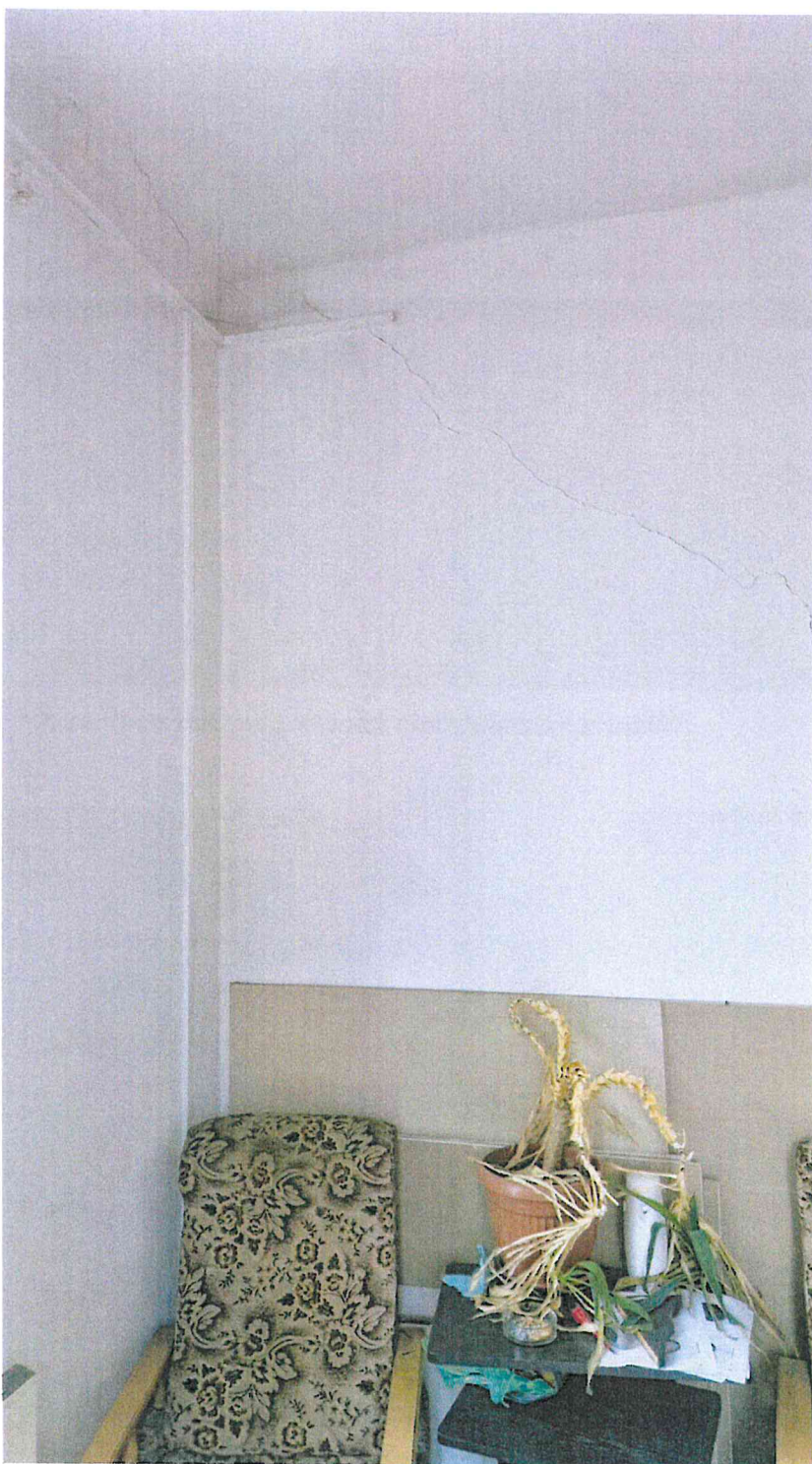
Widoczne uszkodzenia ścian w pomieszczeniu nr 1.
