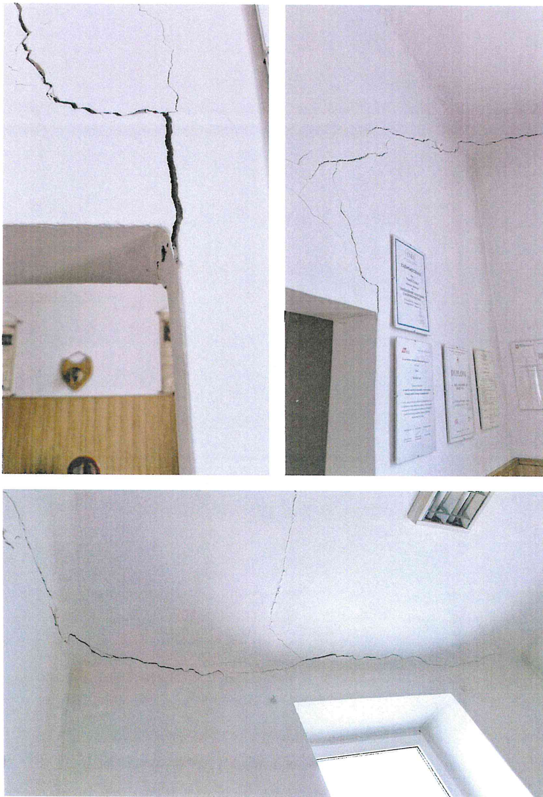
Widoczne uszkodzenia ścian w pomieszczeniu nr 3.
